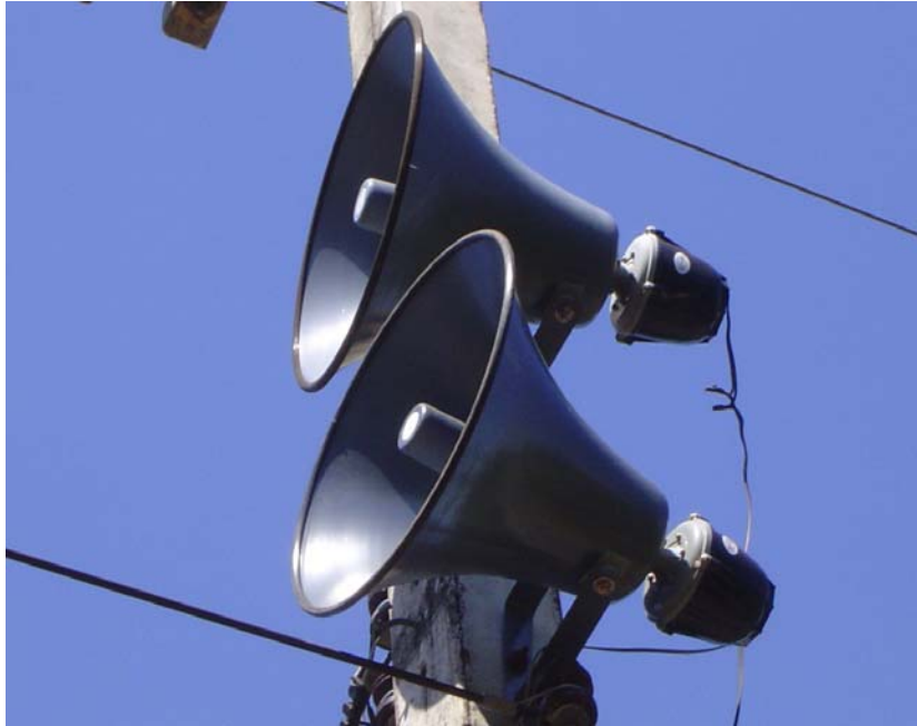
ภาพที่ 2.3.1 ข การติดตั้งลำโพงของระบบเสียงตามสายภายในหมู่บ้านหรือชุมชน
