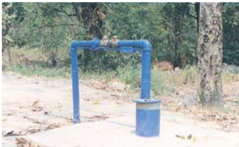
รูปที่ 7 บ่อน้ำบาดาลที่ใช้เป็นแหล่งน้ำดิบ
