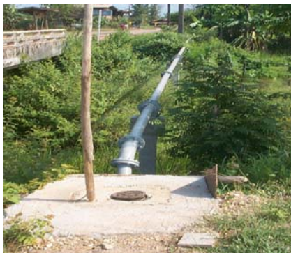
รูปที่ 19 ท่อส่งน้ำดิบระบบประปาแบบบาดาล
